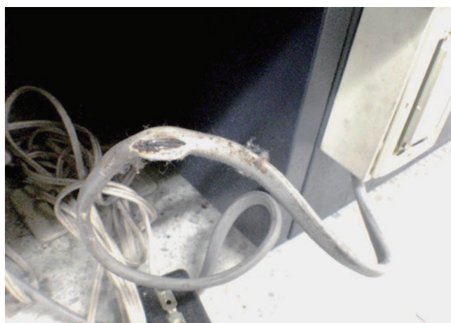
↑スーパーのショーケースと床に挟まり、被覆が破れ素線が露出しショートしたものの
