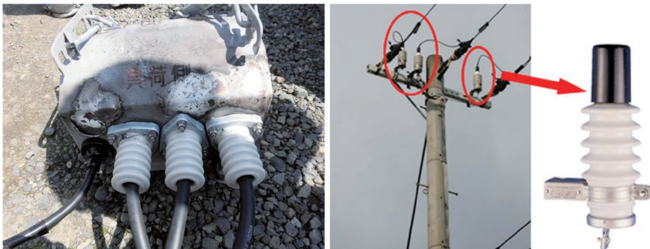
高圧電線路に外付けされた避雷器
