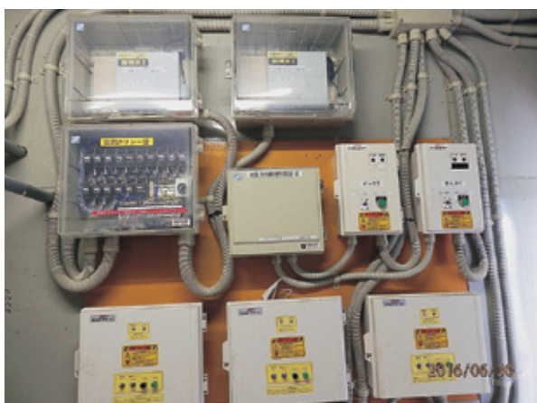
(離乳舎自動給餌制御盤)
